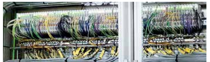
倍福的硬件组件安装在由 Tricon Electric 提供的六个控制柜中，通过功能强大的 EtherCAT 网络相互通信
