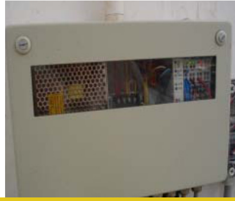
安装在控制柜中的德国 Beckhoff 控制站
