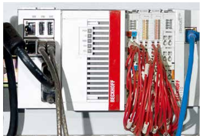
CNC-800A3 控制柜内部视图，其中 CX5120 嵌入式控制器用作中央控制平台
