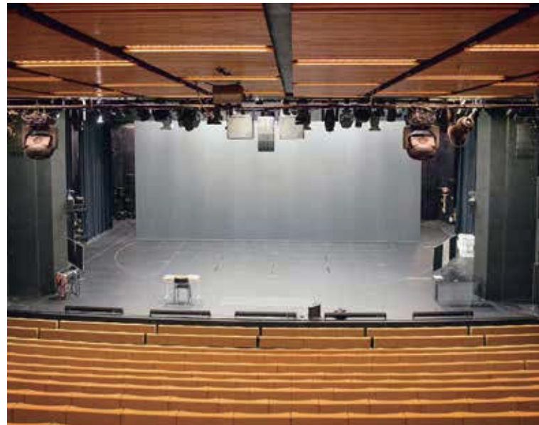
在基于 PC 和 EtherCAT 的控制平台基础上，库奥皮奥城市剧院能够灵活和独立地控制 DMX 环境，集成灯开关和按钮并能够集成第三方系统
