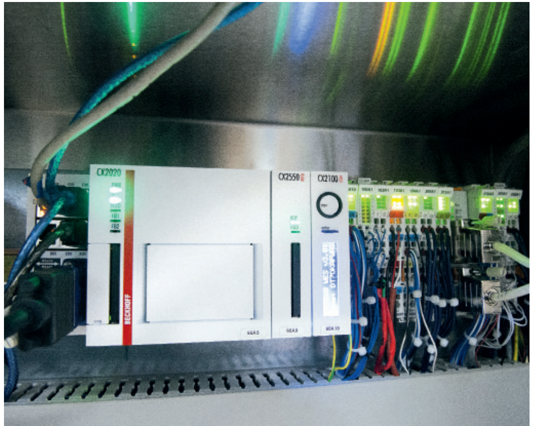
UltraZonic 清洗系统的控制平台由一台直接连接 I/O 组件并装有 TwinCAT 软件的 CX2020 嵌入式控制器构成
