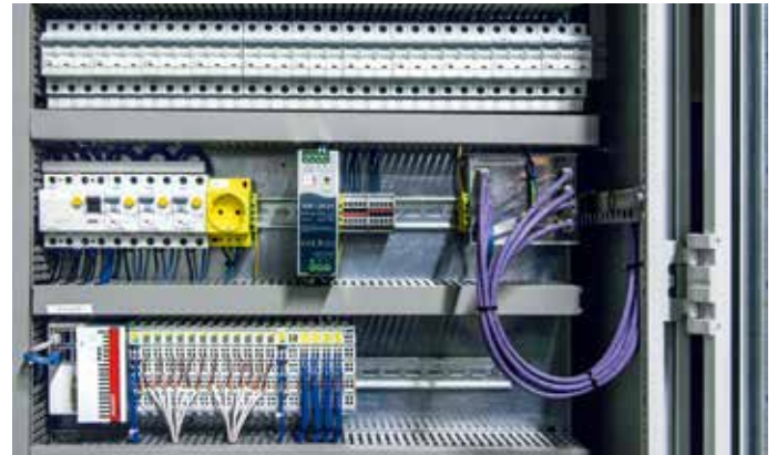
LED 照明系统与 CX5020 嵌入式控制器（底部）和相应的 EtherCAT 端子模块的控制柜
