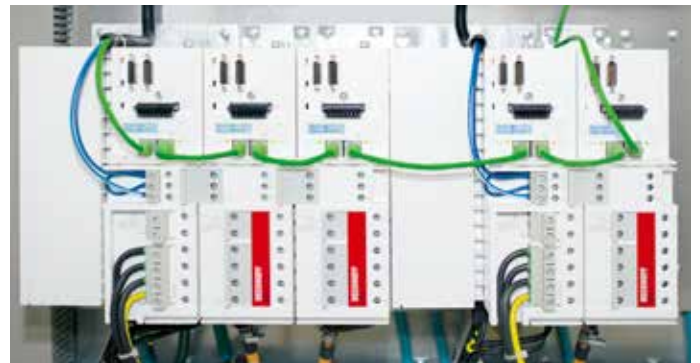
整条生产线使用的控制系统处理 2500 多个数据点硬件包括 73 个 AX5000 伺服驱动器（如图所示）、51 个 EtherCAT 耦合器、778 个 EtherCAT 端子模块及 22 个 EtherCAT 端子盒
