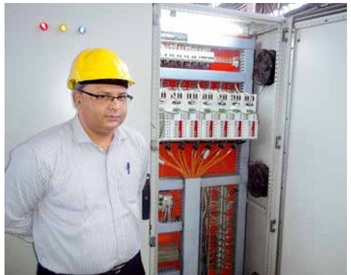
Maneck E. Behramkamdin 正在展示控制柜空间，由采用单电缆技术（OCT）的紧凑型 AX5203 两通道伺服驱动器优化使用
