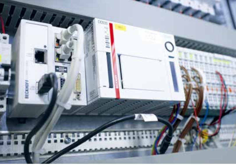
一台 CX2020 嵌入式控制器，采用 Intel®Celeron® 处理器，时钟频率为 1.4 GHz，用于控制整个楼层
