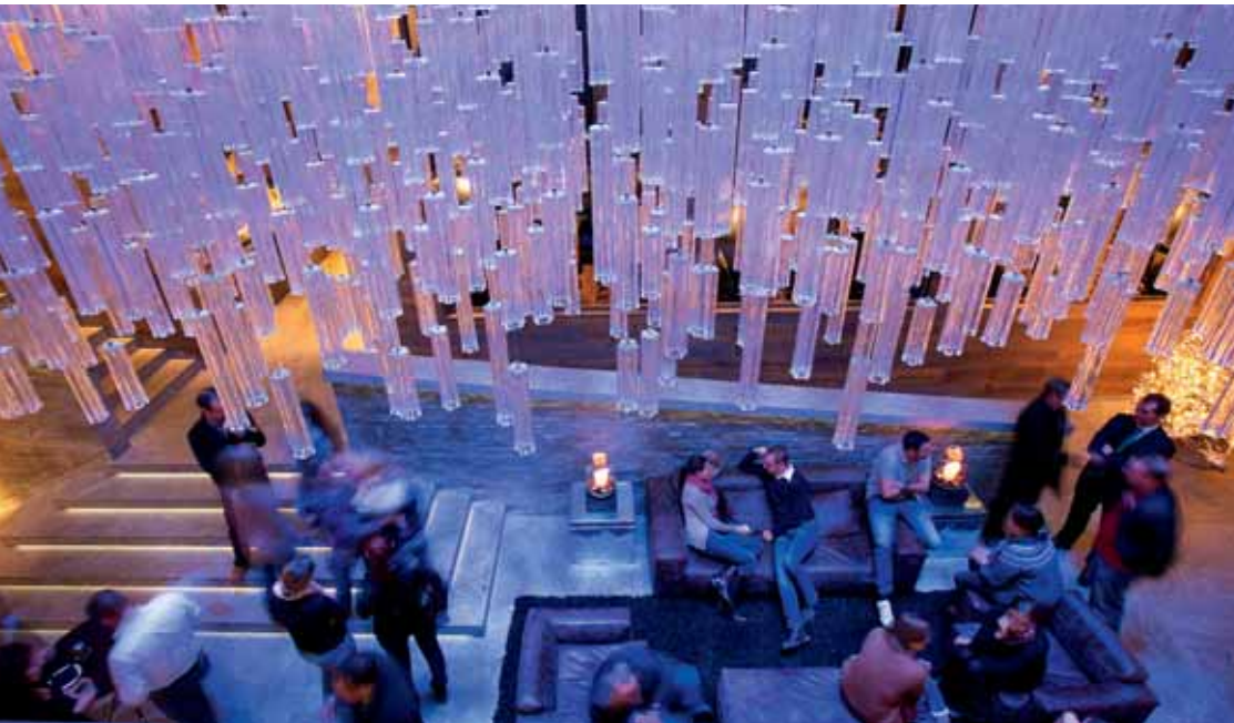
在 Grisca 酒店的接待区有一个大型的“灯光雕塑”，其有 1,400 个慕拉诺玻璃垂饰构成，营造出独特的氛围。该 2/7 米的灯光雕塑由 Beckhoff DMX 端子模块 EL6851 控制，实现了灯光和颜色的动态显示。
